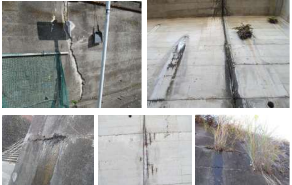
【擁壁劣化の状況】
