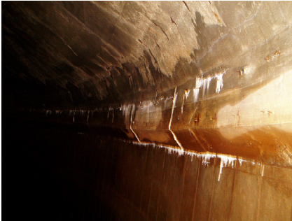
写真1 タンク内の腐食状況
