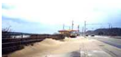
堆砂状況（国道9号）
