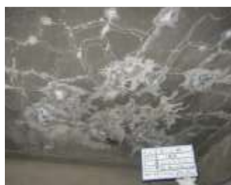
床版（床版ひびわれ、漏水・遊離石灰）
