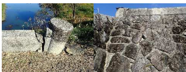
図-2 支柱部の断面欠損及び笠石の損失（左）、壁面の目地部ひび割れ（右）
