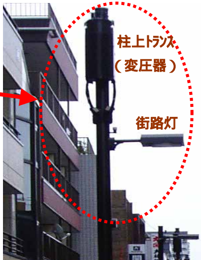
<柱上トランス (上) と街路灯 (下) >
